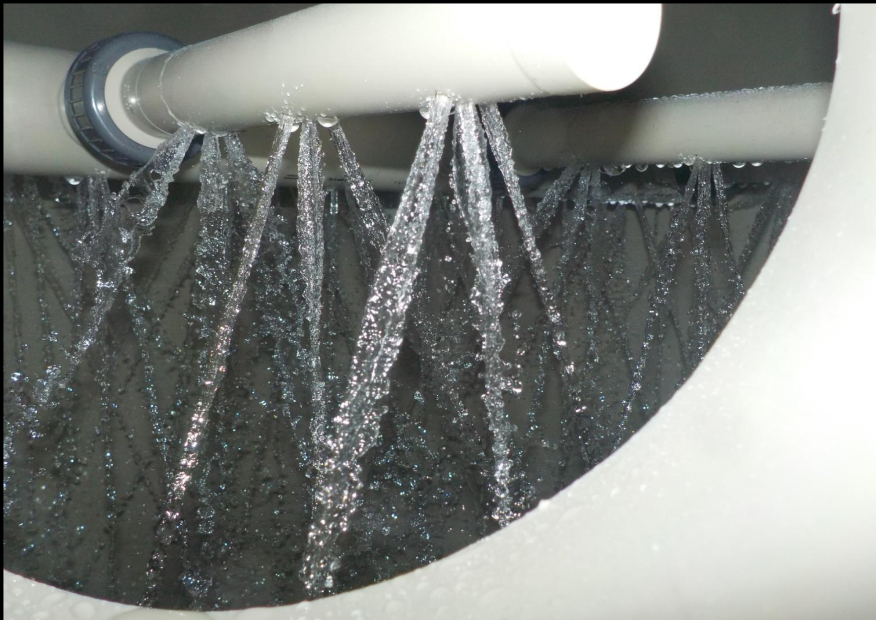
Seitenarm eines Rohrverteilers
